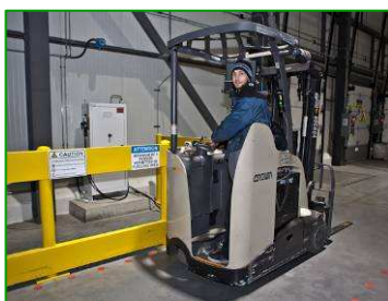
Station de distribution pour chariot élévateur à hydrogène Walmart - Canada
