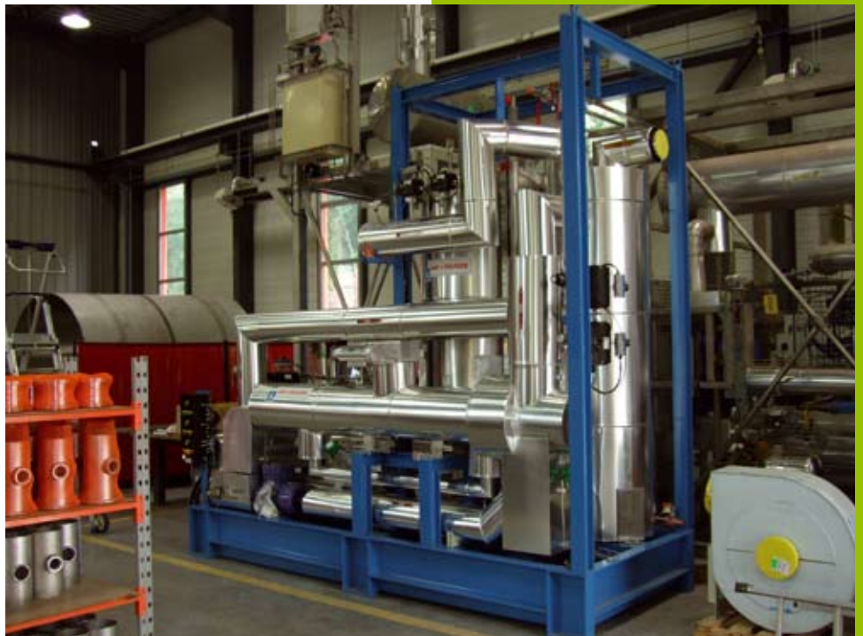
Avant livraison sur le site de Novasep, vue d'ensemble de la centrale Alaska intégrant les trois échangeurs thermiques.
