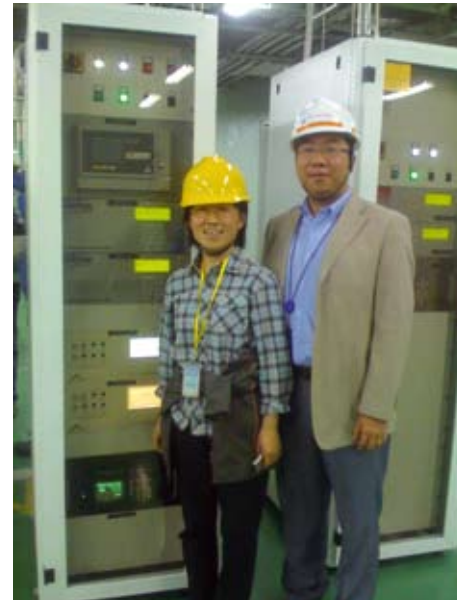
Wang Jing (Air Liquide Electronics Product Quality Manager) et Zhang Hui (Air Liquide Wuxi Gas Center Manager), à l'occasion du démarrage du CQC Hynix 3.
