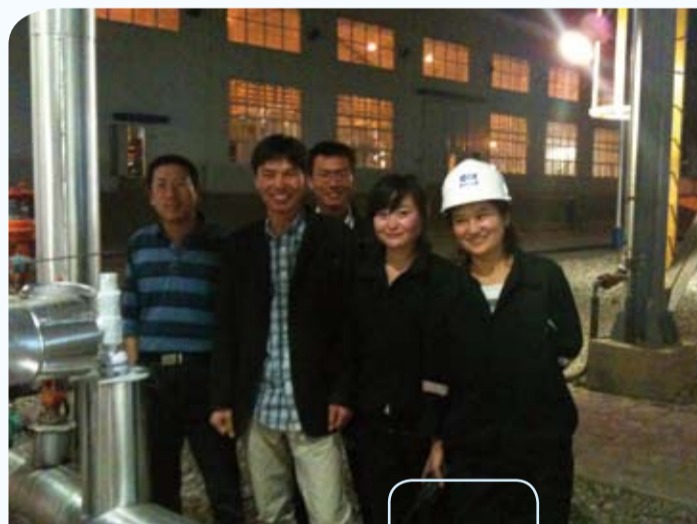
Pendant le démarrage d'un ULTRAL 300 Nm 3 /h dans l'usine HHDC, à Xining, dans la région du QingHai. Un démarrage effectué en relais 24h/24h pour accélérer la mise en route de l'installation.
