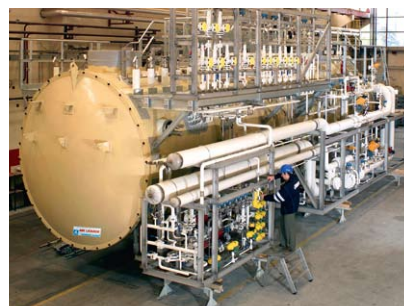
Liquefier cold box
